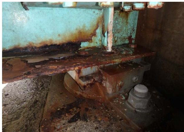
地方自治体管理 主桁腐食
