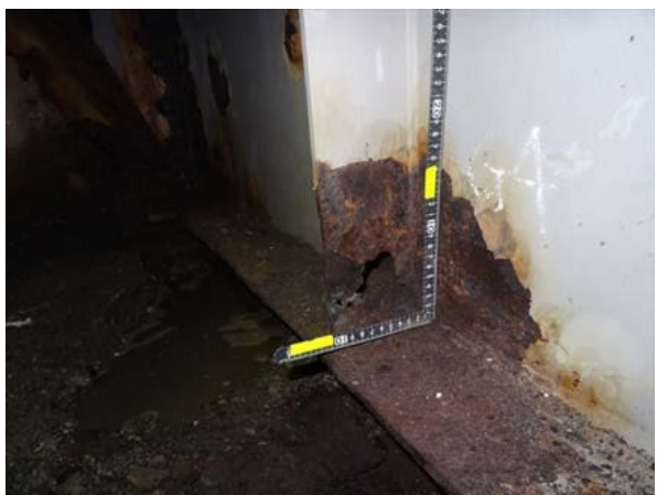
国管理 主桁腐食・欠損
