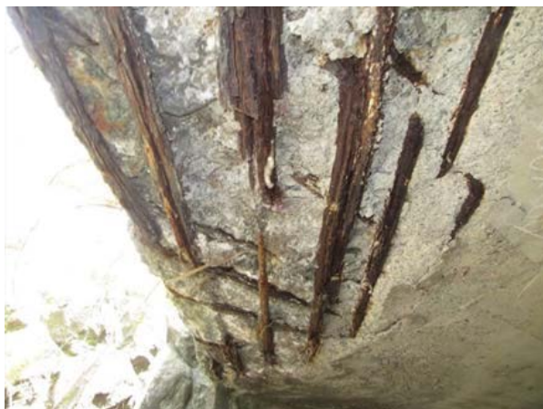
国管理 床版鉄筋露出
