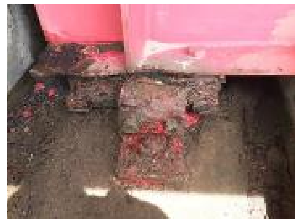
地方自治体管理 支承腐食
