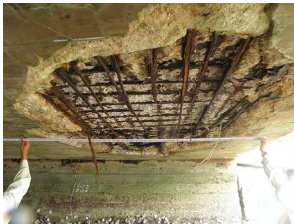
地方自治体管理 床版鉄筋露出
