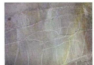
下部工のひび割れ
