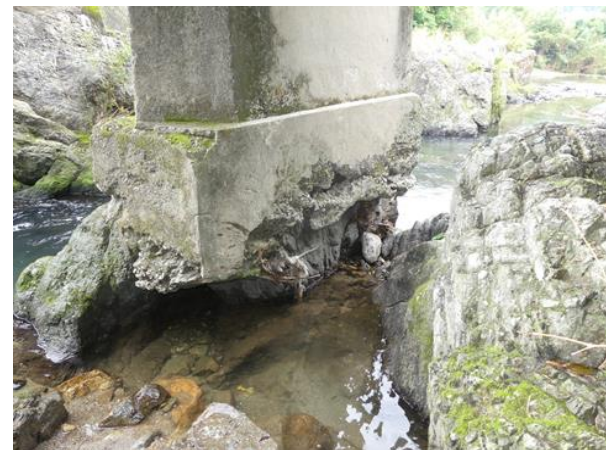
地方自治体管理 橋脚洗掘
