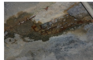
覆工コンクリートの剥落・貫通ひびわれ
