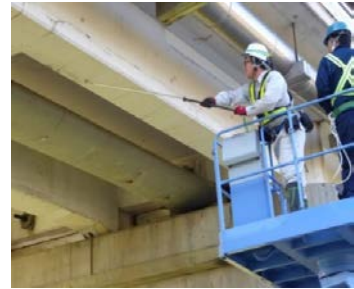
← コンクリートのうき・はく離を非破壊で検査する技術 【5技術】
