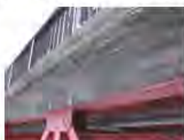
遊離石灰の 滲み出しや漏水
