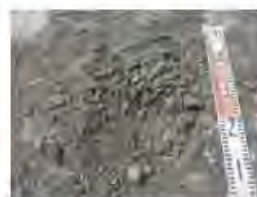
床版表面の砂利（土砂）
