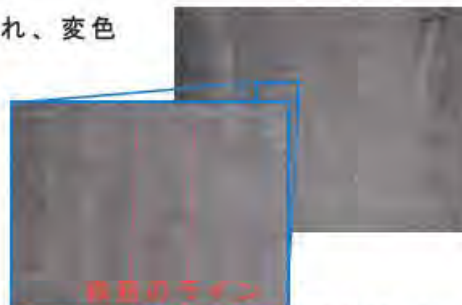
鉄筋沿いの変色と微細なひびわれ
