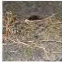
樹の土砂詰まり
