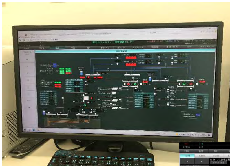
写真8. 中央監視装置（本体用）
