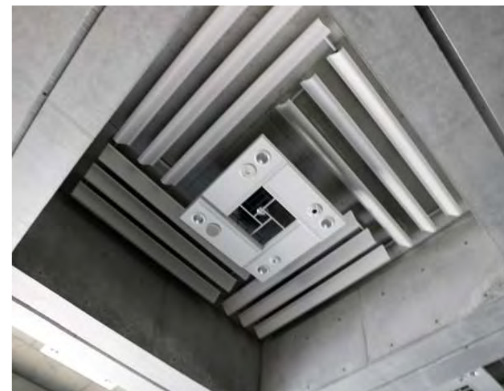
写真2. 放射空調設備/省エネと快適性
