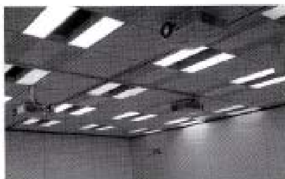
知的照明システム (照度と色温度を制御)
