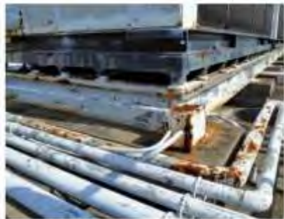
チラー、配管の劣化、錆
