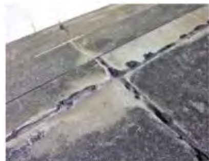
屋上伸縮目地の劣化（隆起）
