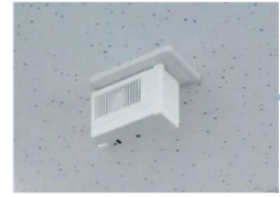
簡易環境計測システム センサーによる温度・湿度等の計測
