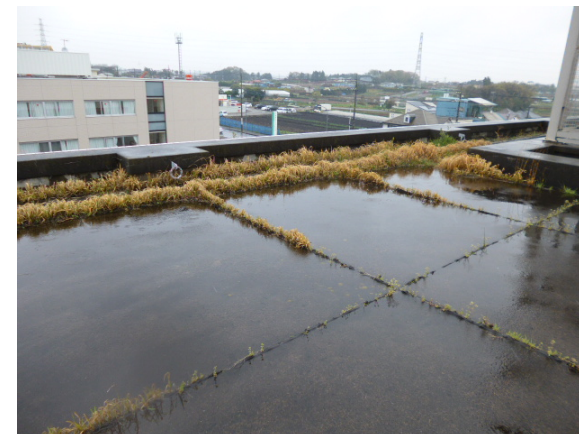
排水溝・伸縮目地の劣化
