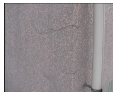
外壁ひび割れ
