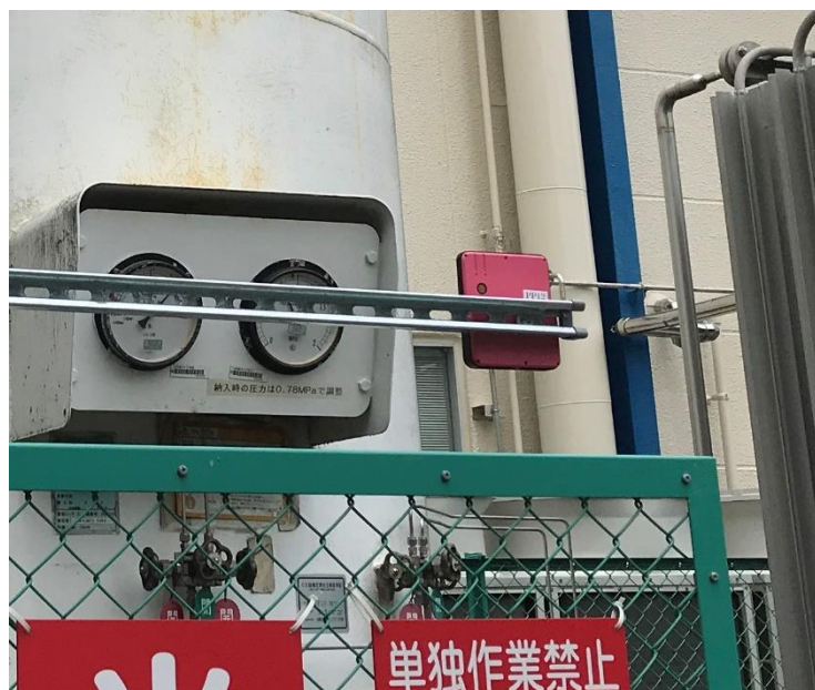
〈外部タンクメーター〉
