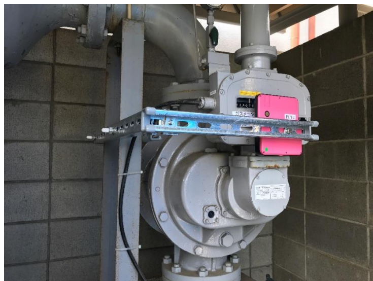
〈外部機械室内〉
