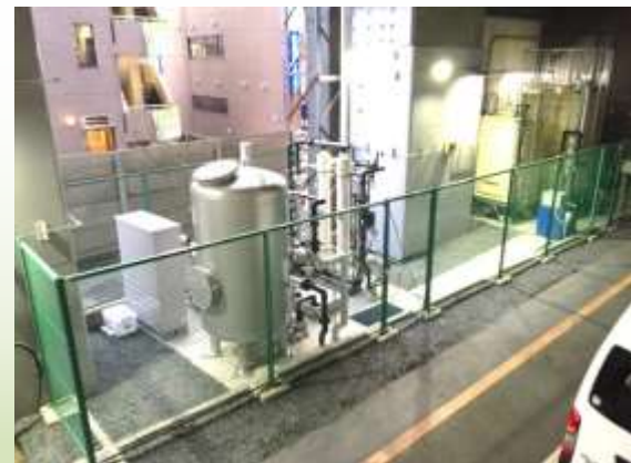
地下水ろ過設備
