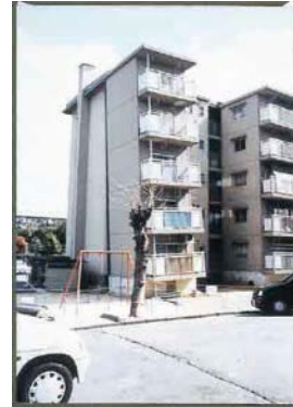
不同沈下のため傾斜した集合住宅
