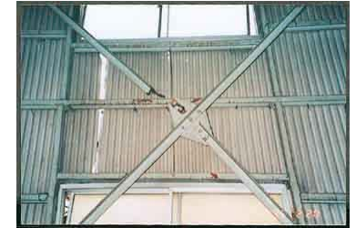
アングル筋違の破断
