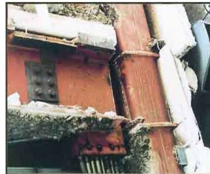
梁端部溶接部の破断
