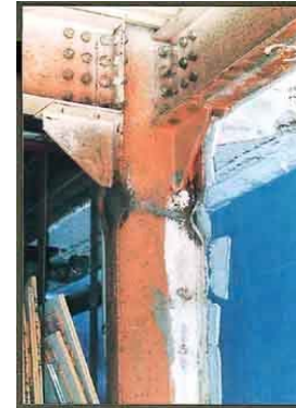
局部座屈を生じた柱
