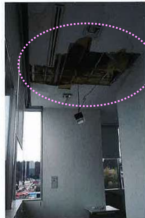
学会の報告書を基に、非構造部材の被害をまとめた(左)。震度7を記録した宮城県栗原市役所(上)でも、天井の落下や柱のタイルのはく落にとどまる。構造体の顕著な被害は報告されていない(写真:東北大学)
