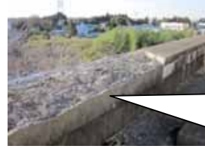
パラペット部分のはがれや浮きの事例。落下すると大変危険です。
