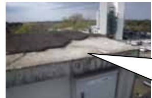
笠木モルタルのはがれや浮きの事例。落下すると大変危険です。
