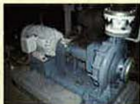
更新した温水ポンプ
