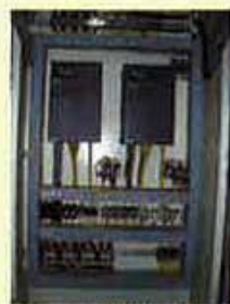
冷却水ポンプ インバータ
