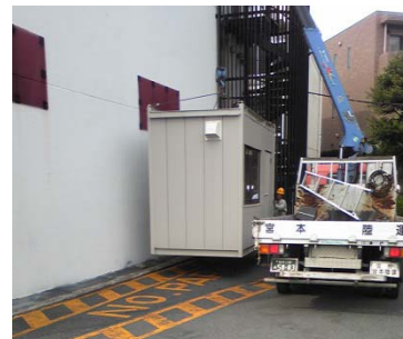
工事における資材等は仮設資材置場に保管し、普段の支障とならないよう配慮
